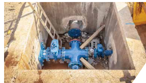
Einbindung TT-Stück im Schacht mit Absperrschieber
