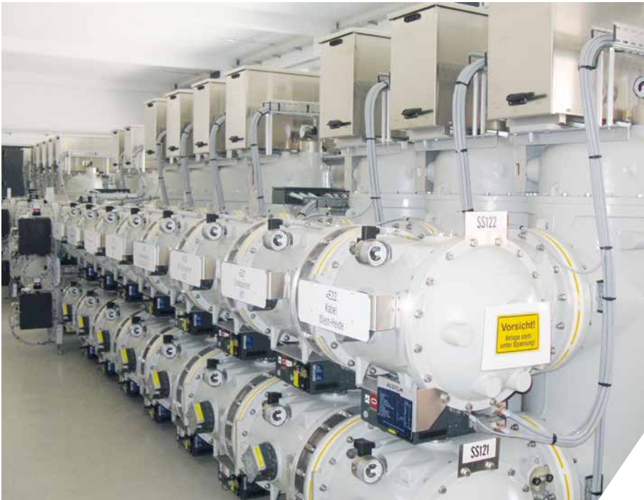
Im Umspannwerk West wurde die gasisolierte 110-kV-Schaltanlage bereits auf den Stand der Technik gebracht und dient nun als Vorbild für weitere Umspannwerke.
