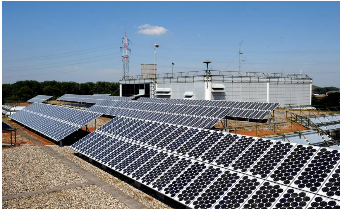
Die fertige Photovoltaikanlage
